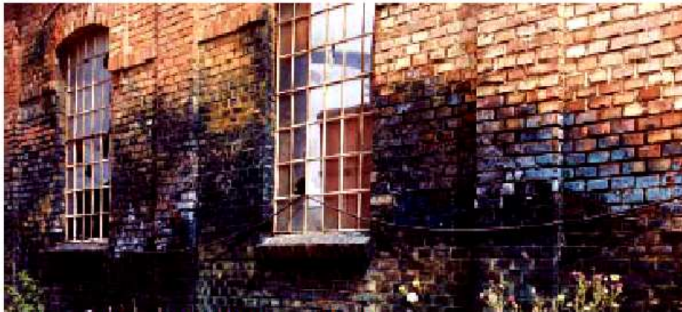
Cyanidkontaminiertes Mauerwerk • Masonry contaminated with cyanide
