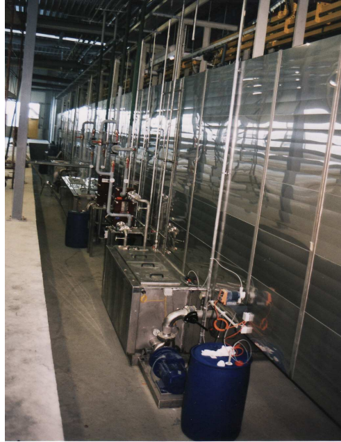
Kombispritzanlage für Stahl mit Eisenphosphatierung und Aluminium chromfrei mit Nabutan STI 310. Vollautomatische Zudosierung und integrierte Anlage für vollentsalztes Spülwasser.
